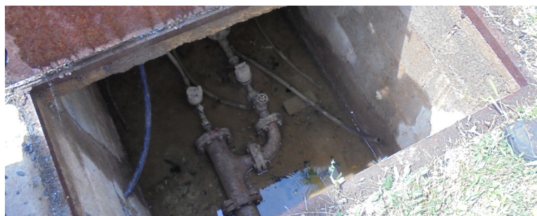
Exemple de compteurs d'eau bétonnés problématiques
