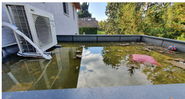
Illustration de toitures-terrasses problématiques retenant l'eau
