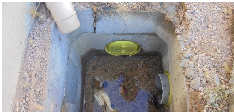
Exemple de descentes de chéneaux avec décanteur
